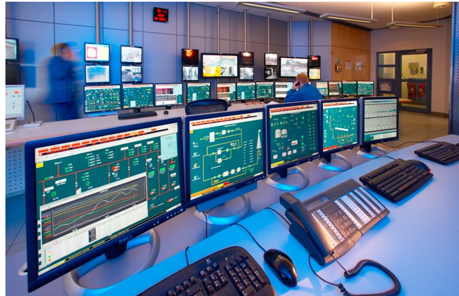
In unserem modernen Leitstand wird die bedarfsgerechte und umweltverträgliche Erzeugung von Fernwärme gesteuert und überwacht.
